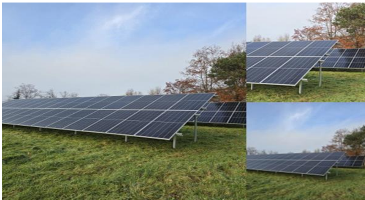
Fot. nr 35. Instalacja fotowoltaiczna na terenie Gminy Radwanice.
