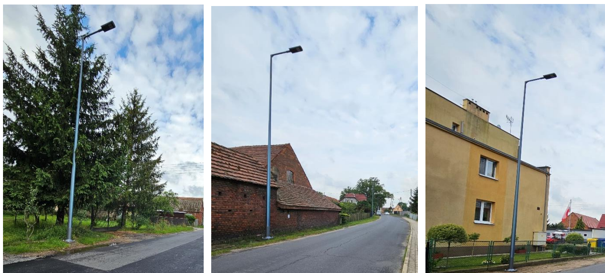
Fot. nr 18. Oświetlenie uliczne przy ul. Przemysłowej w Radwanicach.
